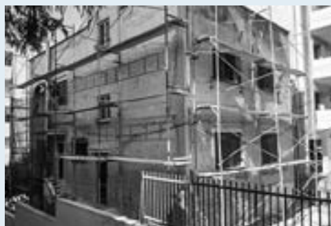
Το κτήριο όπου στεγάστηκε το 1ο Γυμνάσιο Καλαμακίου στις εργασίες ανακαίνισής του
